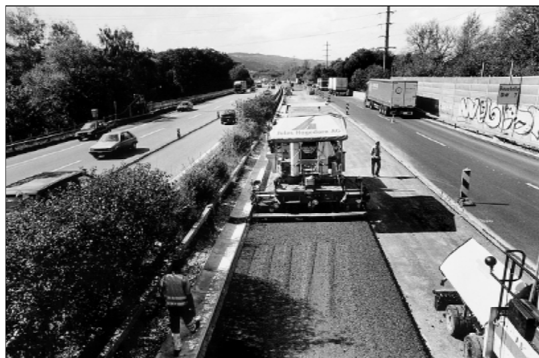
Die Belagsfertigermaschinen bringen die Heissmischtragschicht aus; bei schönem Wetter rund 400 Meter pro Tag. (Bild Hofer/b.)
